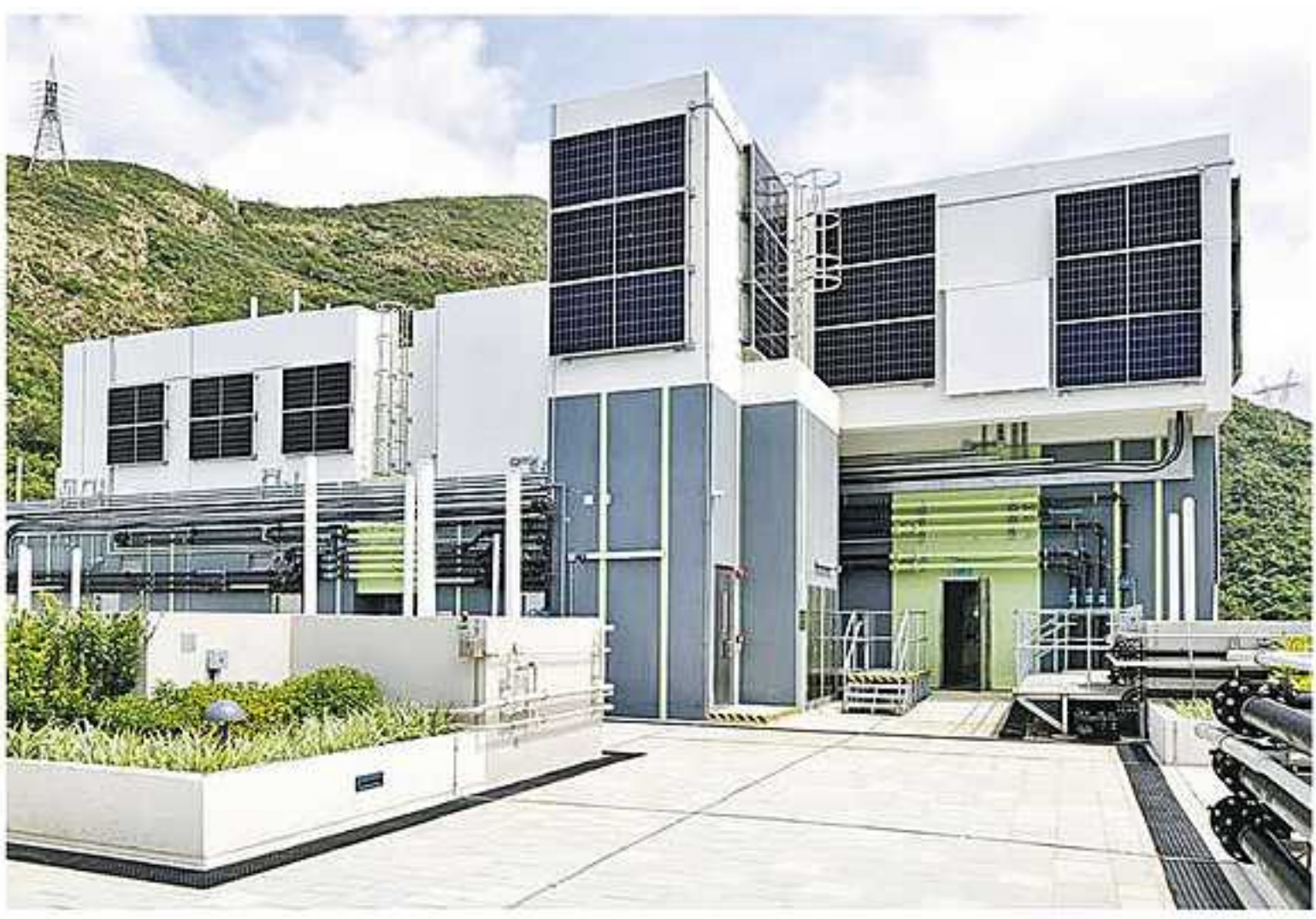
▲房協已在部分出租屋邨安裝太陽能發電系統，以再生能源作公共照明。
